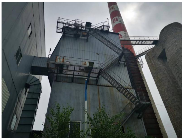
现有工程烟气净化设施
