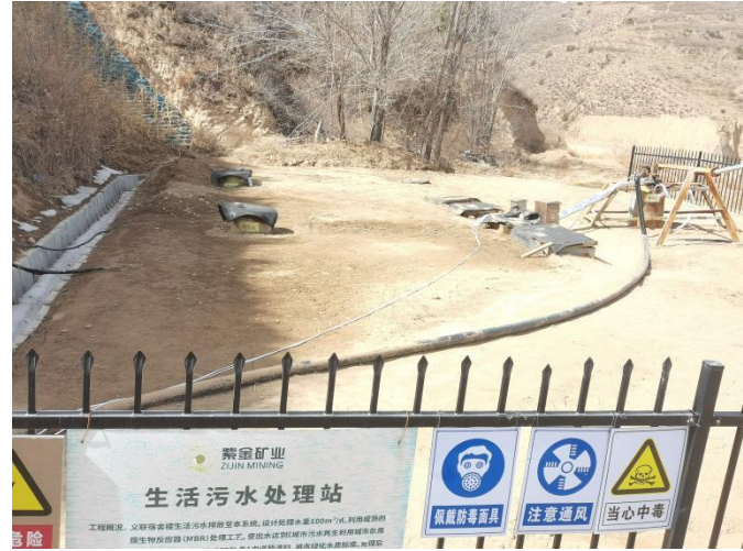
现有生活污水处理站
